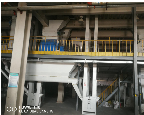
粉碎系统布袋除尘装置
